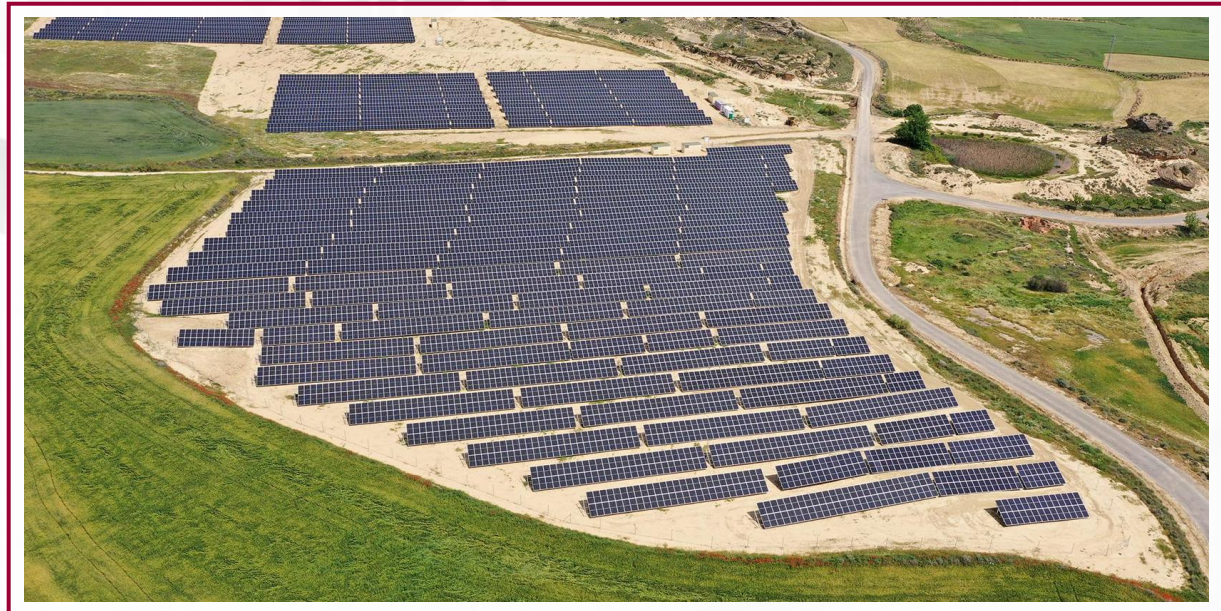
Parque de generación fotovoltaica Tormillo III y IV (Huesca) Potencia de 2,4 MW 5.206 módulos de paneles solares
